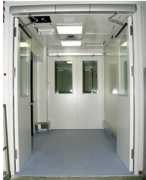
Materialschleuse: 2-flügelige Drehtür mit automatischem Antrieb
