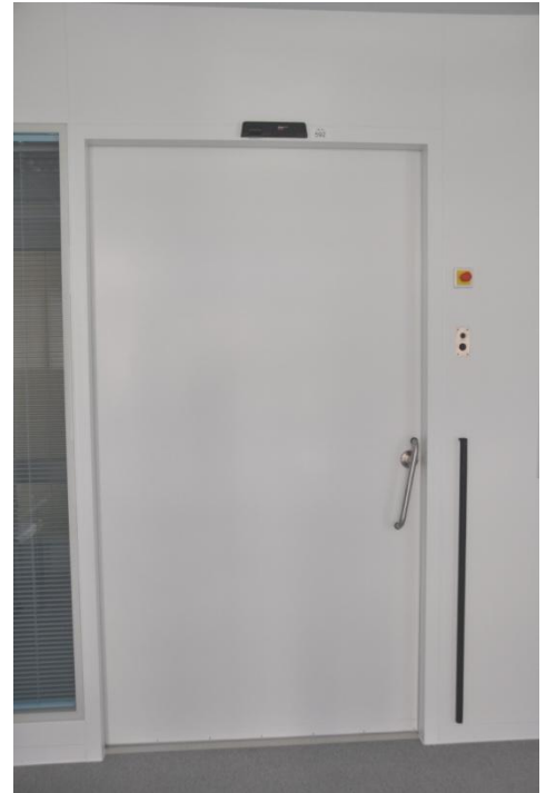
Automatisierte Schiebetür mit Rot-Grün Anzeige, Not-Aus Schalter sowie Schlagleiste
