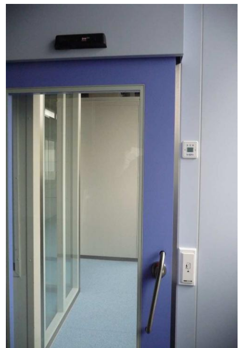
Automatisierte Schiebetür mit Bedienungseinheit und Sensorleiste
