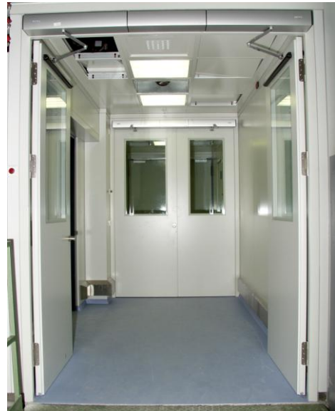
Materialschleuse: 2-flügelige Drehtür mit automatischem Antrieb
